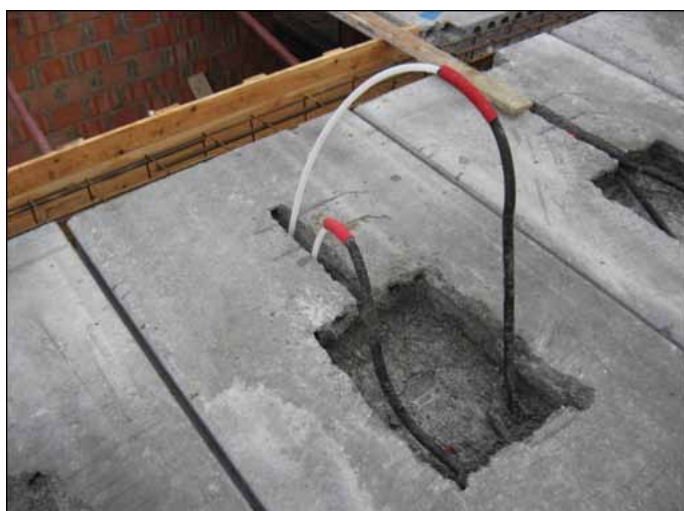
Abb. 9 Rohrdurchführung nach unten
